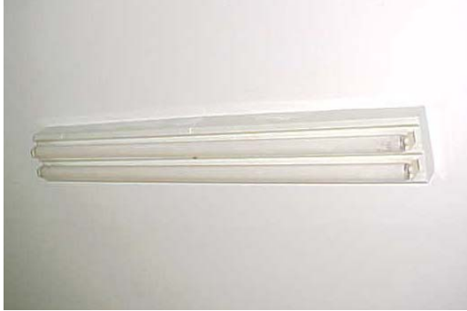
Figura 16. Luminária instalada no ambiente.
