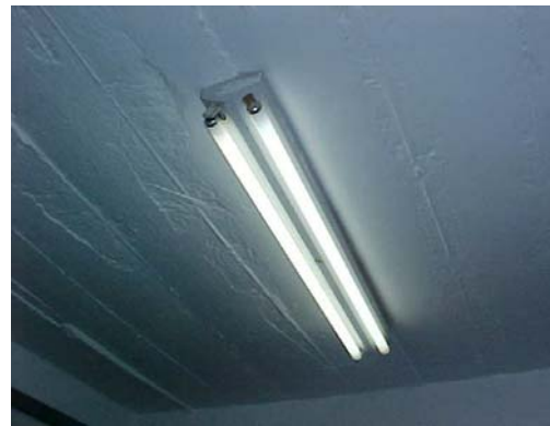
Figura 19. Exemplo de Suporte de lâmpadas de 40W utilizado em 25% das Salas de Aula
