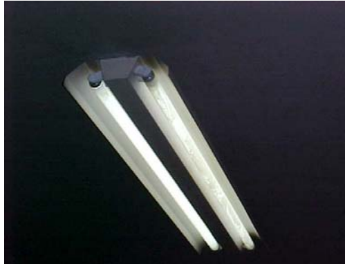
Figura 16. Falta de manutenção do sistema de iluminação - Sala de triagem do CCS
