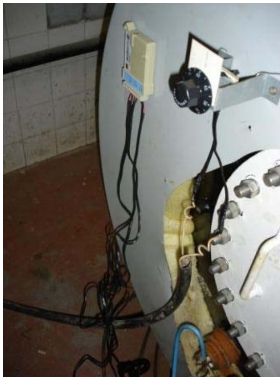
Figura 7. Medição da caldeira elétrica.
